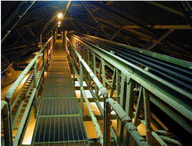
Bild 1 Servicebrygga ovan pelletstack i planlager.
